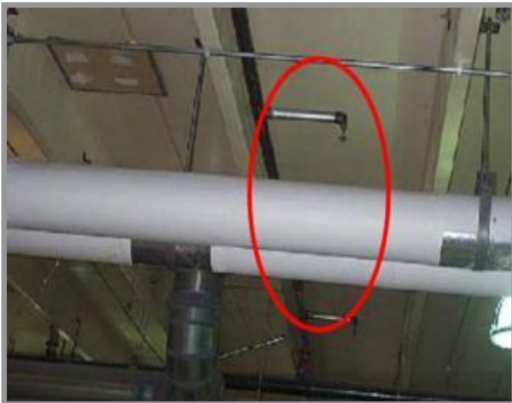
中国建科 中国航 喷头洒水受到遮挡
