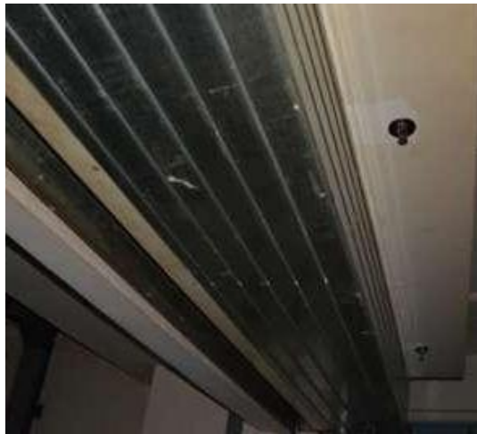
自动喷水防护冷却系统
