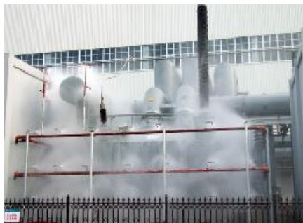
水雾直接喷射和覆盖保护对象
