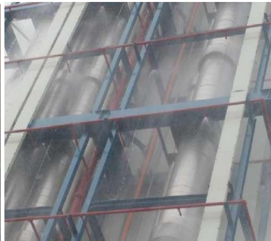
LNG储罐用水喷雾防护冷却系统
